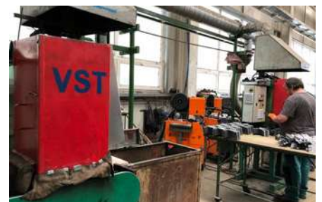
Die VST Schlosserei wird demnächst um eine Schweißanlage erweitert
